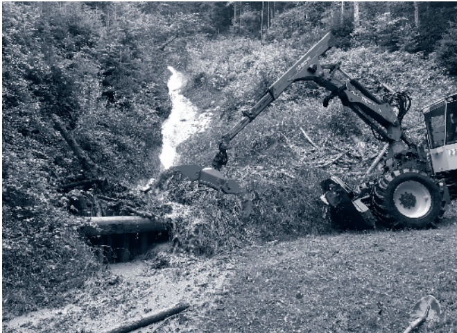
«Fünf vor Zwölf» im Jonenwatt ob der Kantonsstrasse
